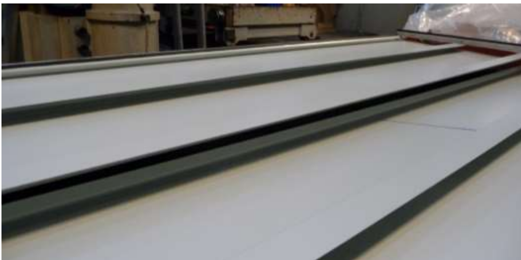
Figura 1.9 Collasso per dislocazione del giunto per la prova di flessione eseguita su campata doppia, sottoposta a carichi di aspirazione
